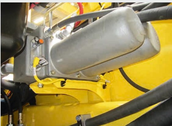
Monitorización electrónica del sistema de filtro de retorno hidráulico.
