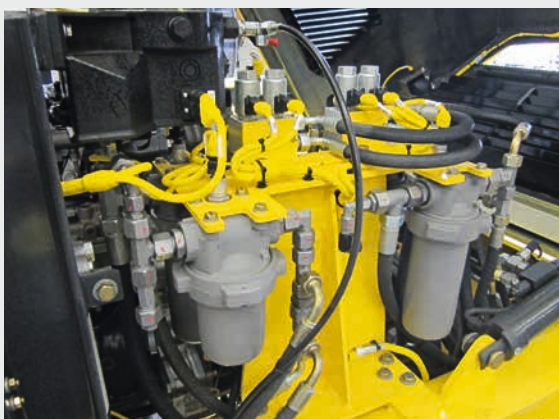
Lado de descarga del sistema de filtro hidráulico.
